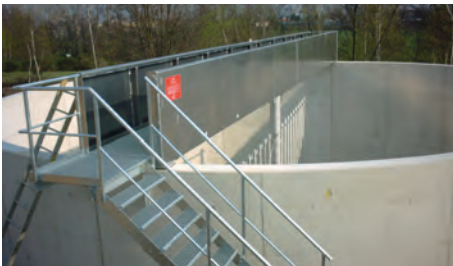
▪ HIK Krählwerk mit Tragbrücke / HIK thickener with supporting bridge
